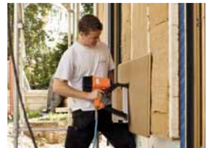
Ausdämmung der Wandgefache mit STEICOflex. Gefachabschluss mit STEICOuniversal als zweite wasserführende Schicht hinter der Lärchenholzschalung.
